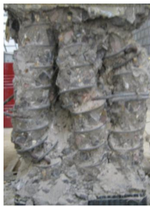
(d) Rupture of transverse reinforcement
